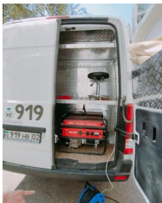
Рис.12. Генератор MC6500 для обеспечения бесперебойного питания для необходимого оборудования
