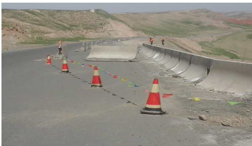
Рис.1. Поврежденный участок откосов автомобильных дорог Ош-Исфана.
