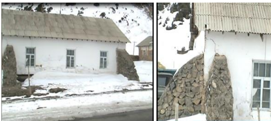
Рис.2. Отрицательное влияние (трещины в домах) большегрузных АТС превышающих допустимые нормы.
