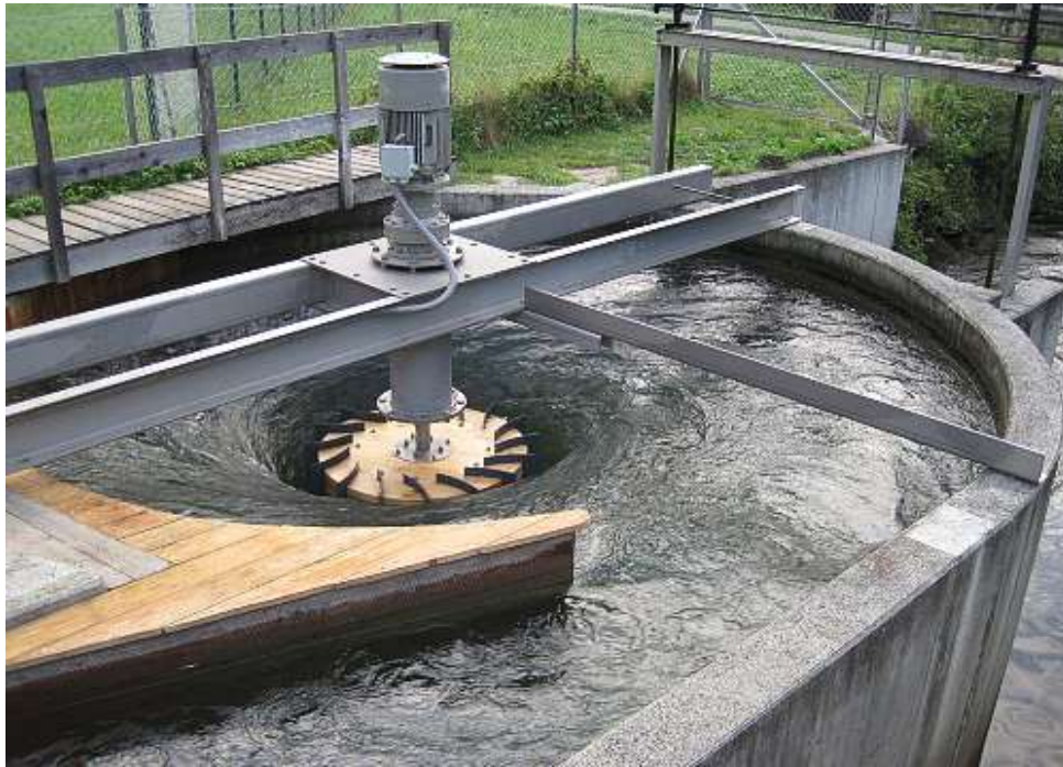
Рис.1 Водоворотная микро ГЭС
